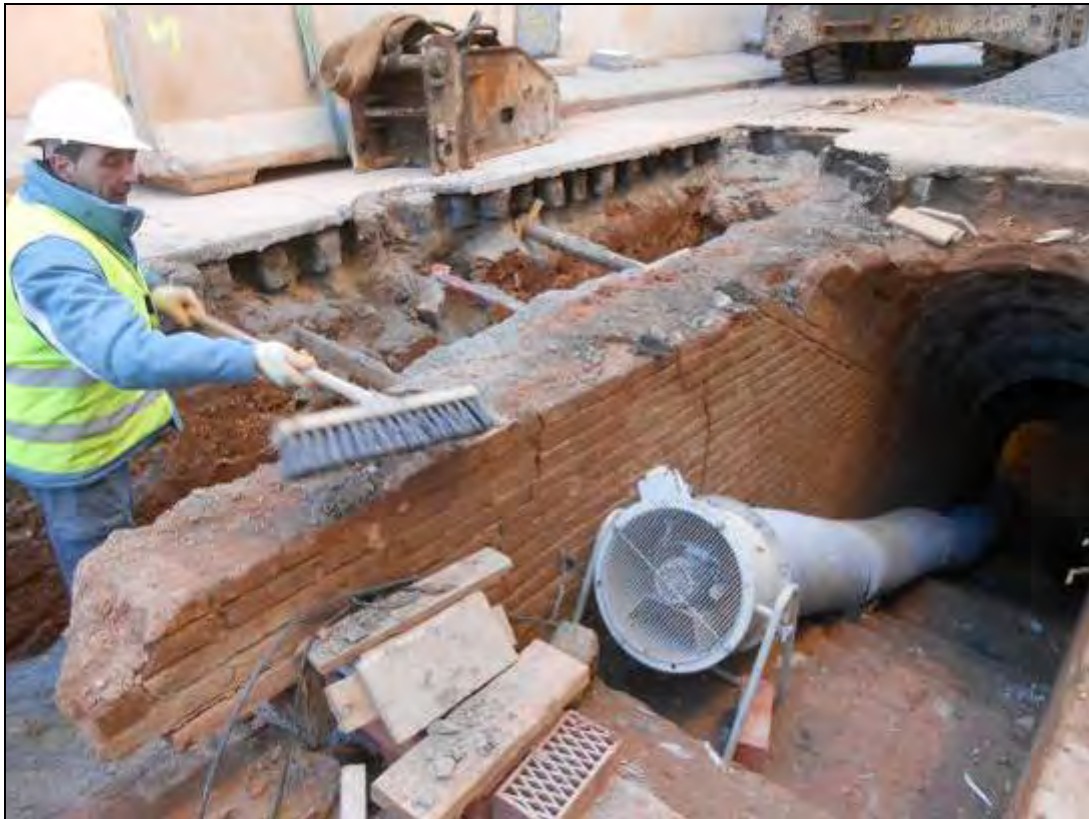
Foto 50: Tram 1. Vista de les obres de la rasa per al col·lector al costat del refugi.
