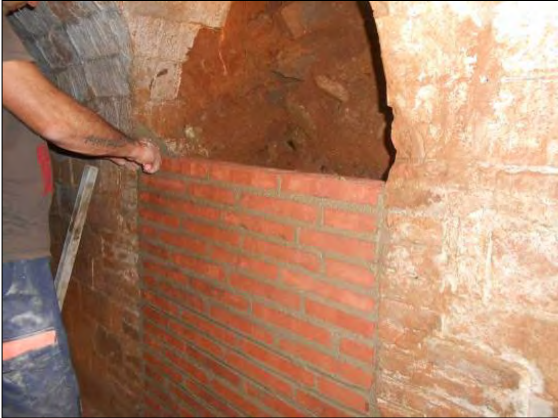
Foto 322: Tapiant l'accés per motius de seguretat.
