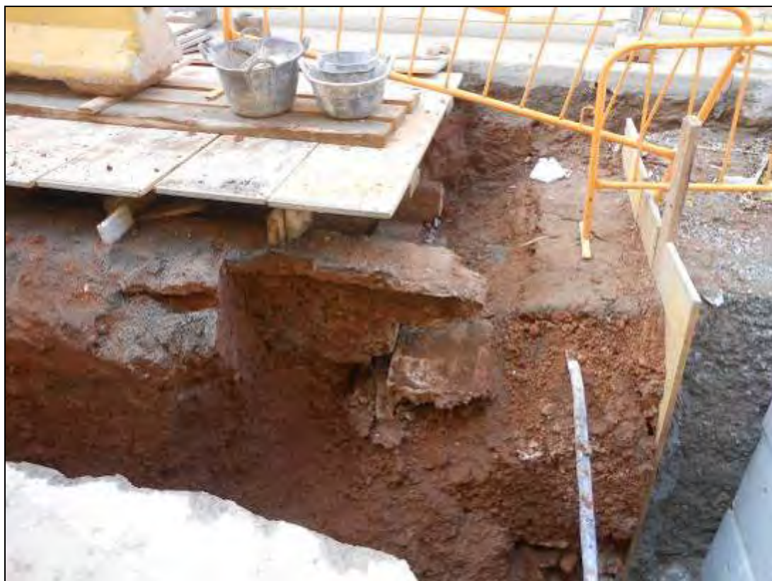
Foto 49: Tram 1. Vista del primer esglaó de l'accés al refugi afectat per l'obra.
