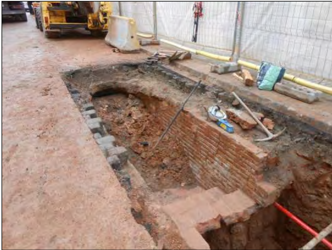
Foto 230: Vista de l'accés del refugi amb tota la runa.
