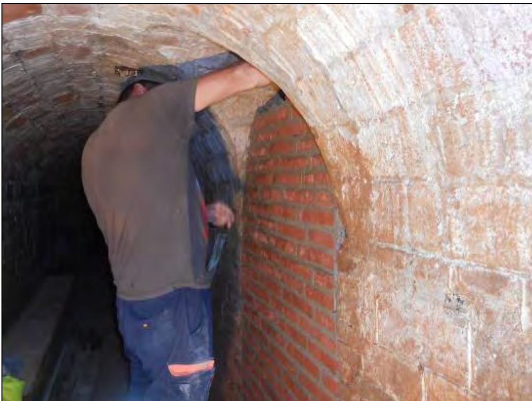
Foto 323: Tapiant l'accés per motius de seguretat.
