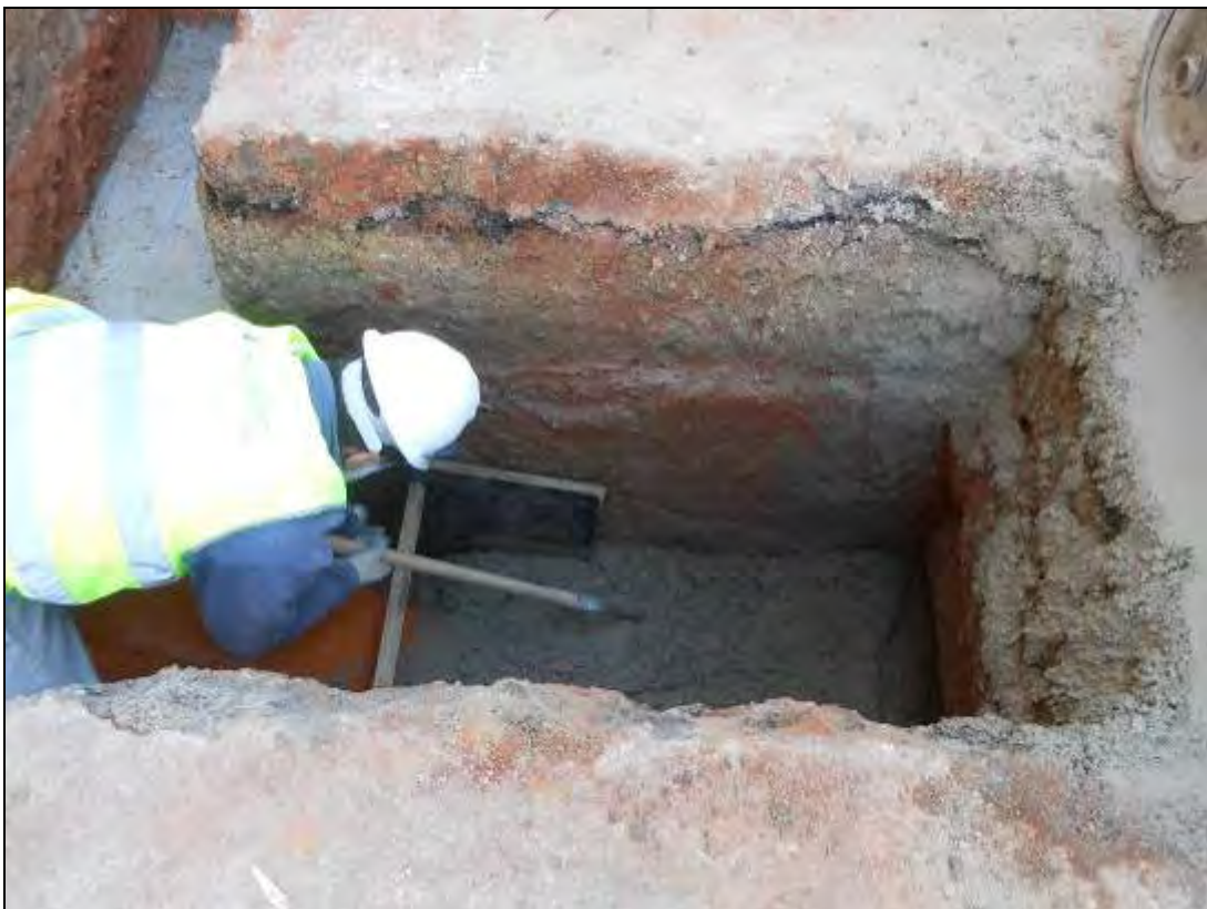
Foto 168: Tram 3. Tapant la boca de la galeria amb el tauló i el formigó.
