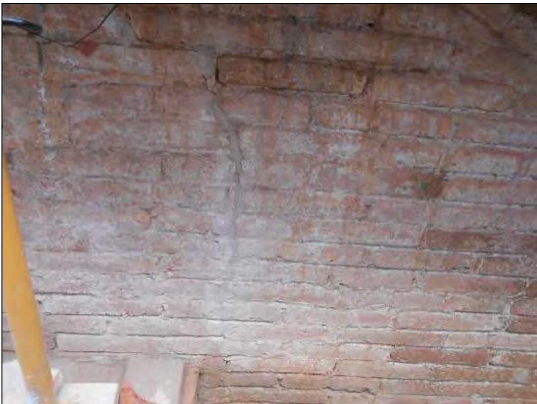
Foto 385: Vista de la restauració de les esquerdes que van sortir durant els moviments de l'obra.
