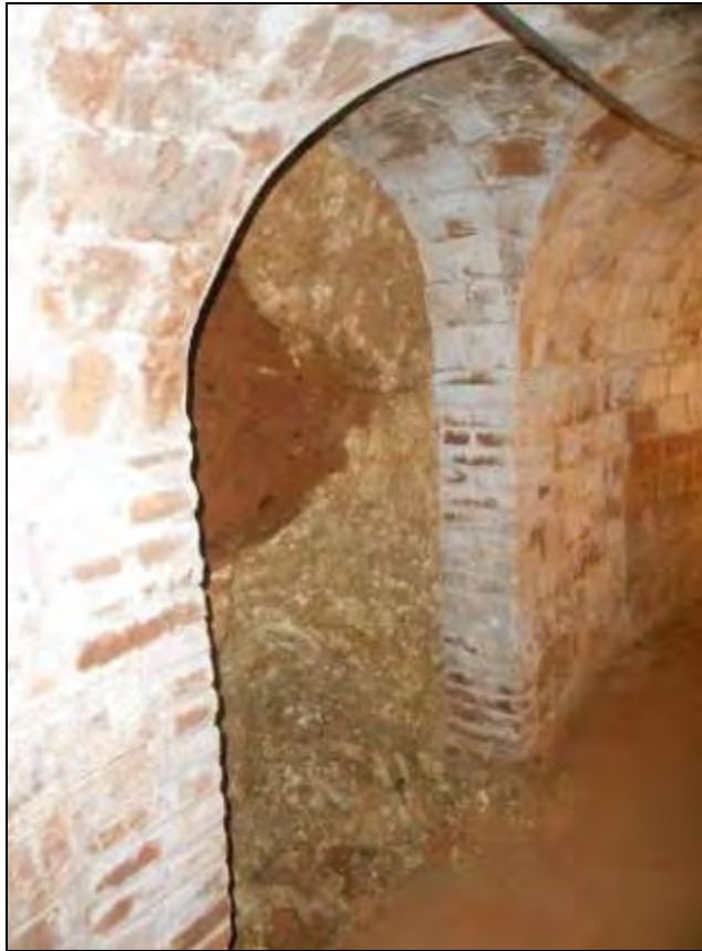
Foto 340: Ramal 3 construït al mig del passadís del banc 7. Foto feta des de l'entrada.
