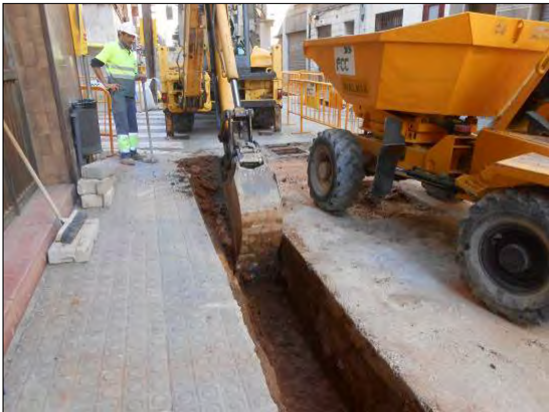
Foto 218: Tram 4. Rasa per a cablejat elèctric entre els carrers Amargor i Trinxant.
