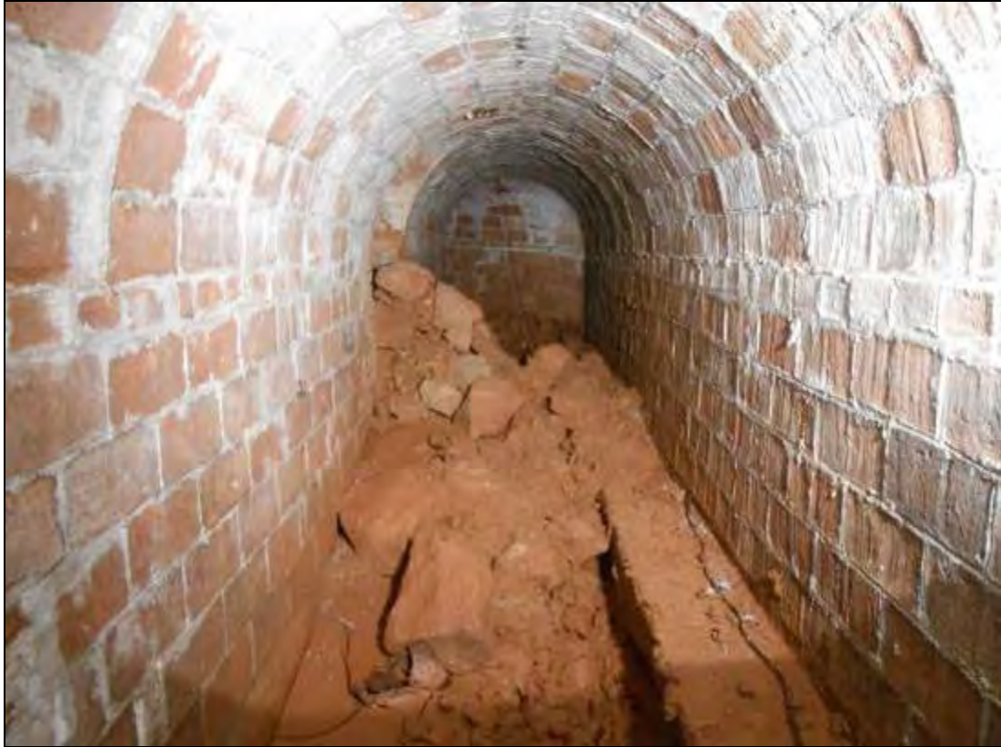
Foto 312: Tram del refugi amb el banc 4. Es pot veure la gran acumulació de runa provinent del pou d'accés o de ventilació. Foto feta en direcció a l'entrada.
