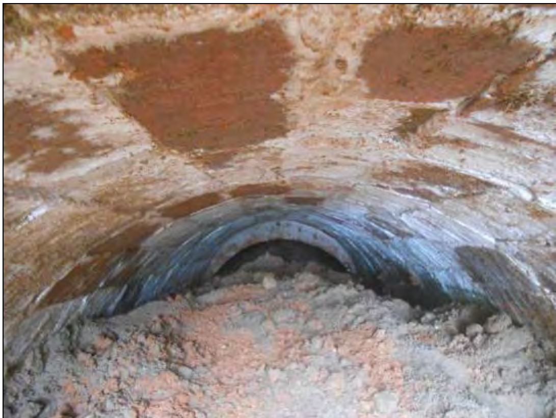
Foto 233: Vista de l'interior de l'accés tot reblert de runa.
