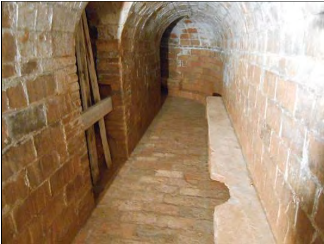
Foto 320: Tram del refugi amb el banc 4 després de ser netejada la zona. Es pot veure que el banc està malmès pels grans rocs despresos pel pou d'accés o de ventilació. Foto feta en direcció a l'entrada.
