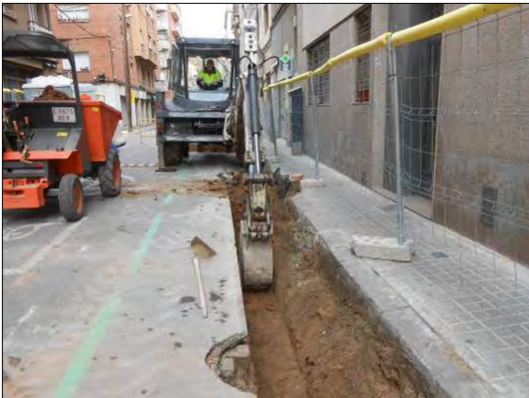
Foto 180: Tram 4. Treballs a la rasa per a embornal entre els carrers Sospir i Amargor.
