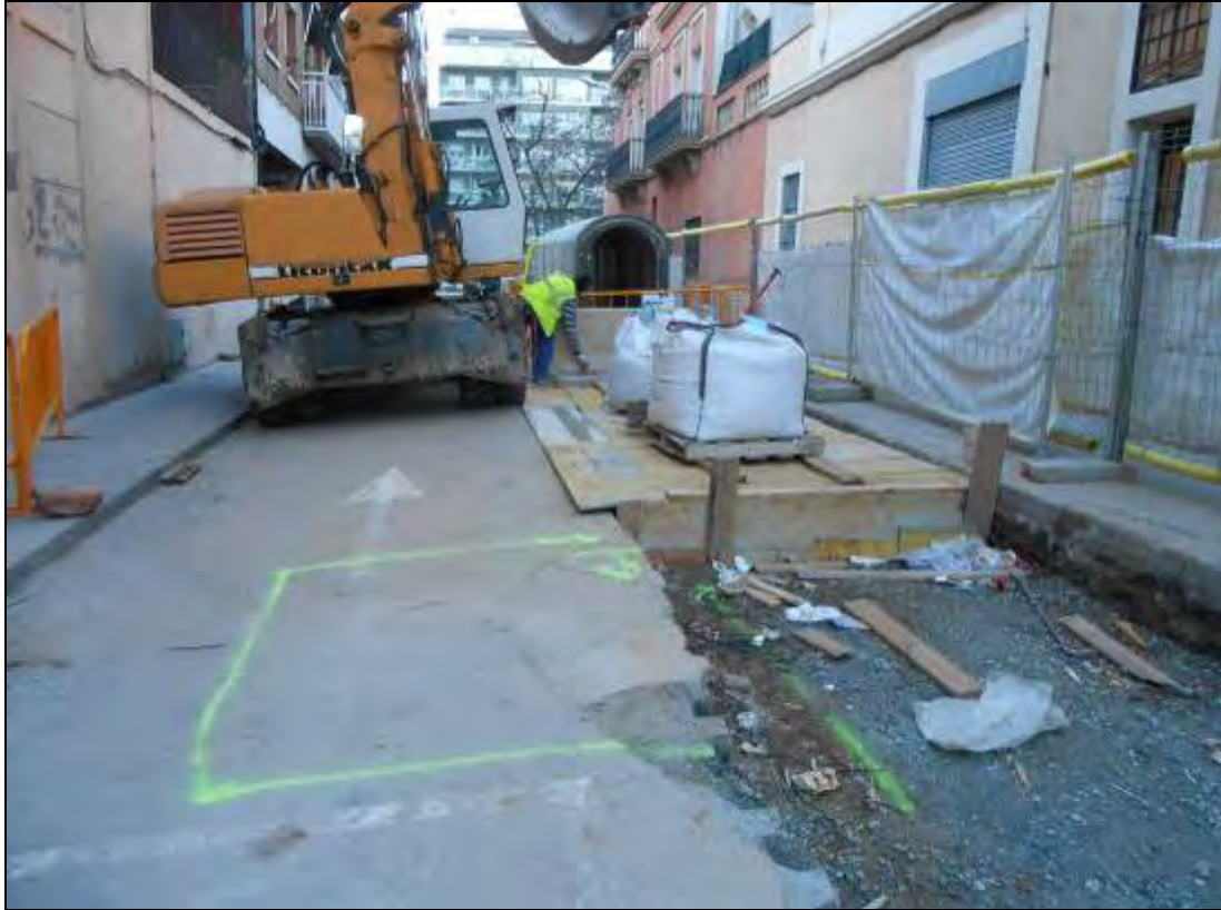
Foto 40: Tram 1. Inici de l'ampliació del col·lector. Es veu l'accés del refugi tapat amb taulons i dues saques plenes de runa. Així es va mantenir tancat durant tot els dies que va durar l'obra, fins al seu tancament definitiu.
