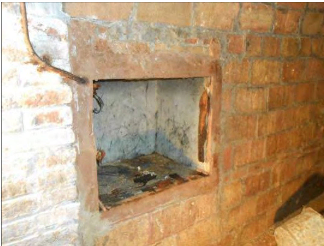
Foto 347: Armariet d'obra al ramal 4.
