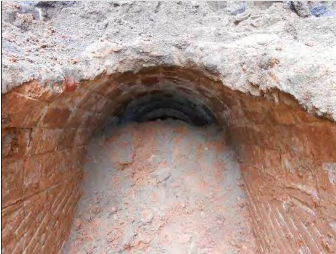
Foto 232: Vista de l'interior de l'accés tot reblert de runa.
