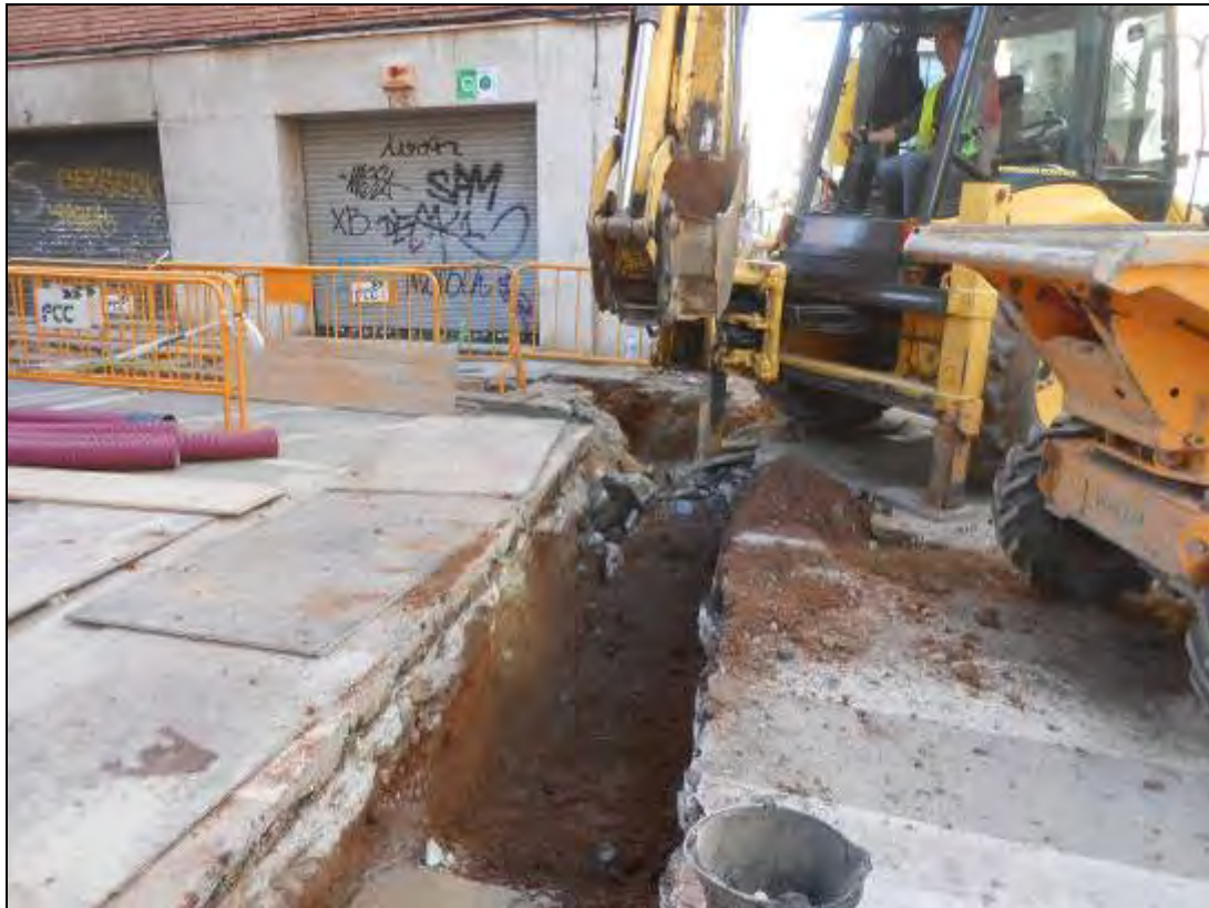
Foto 219: Tram 4. Rasa per a cablejat elèctric al carrer Trinxant.
