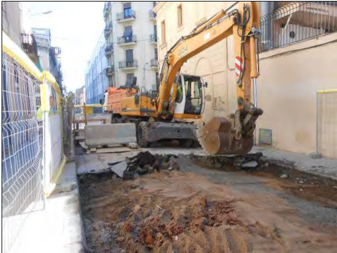
Foto 62: Tram 1. Aixecament de l'asfalt al costat del refugi.
