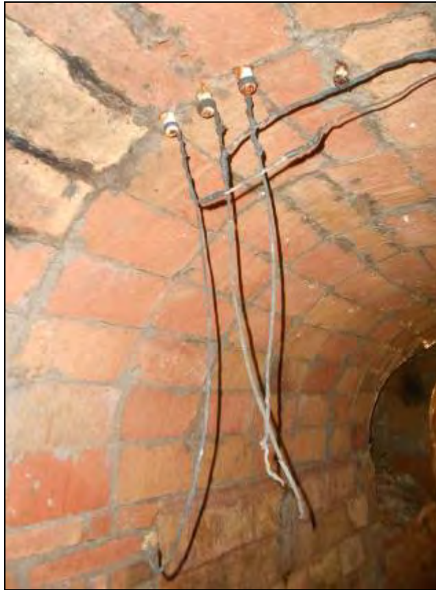
Foto 352: Cables de la llum a ramal 4.
