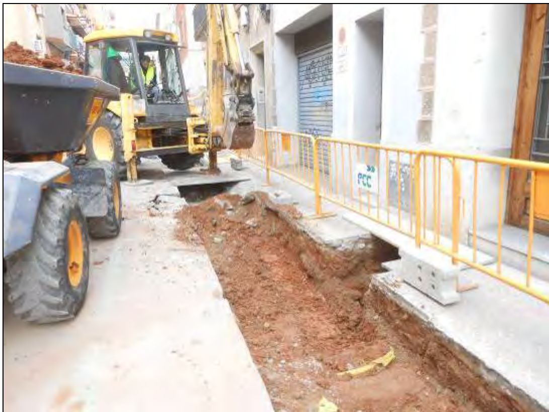
Foto 192: Tram 4. Rasa Per a serveis de subministrament elèctric entre els carrers Nació i Sospir.
