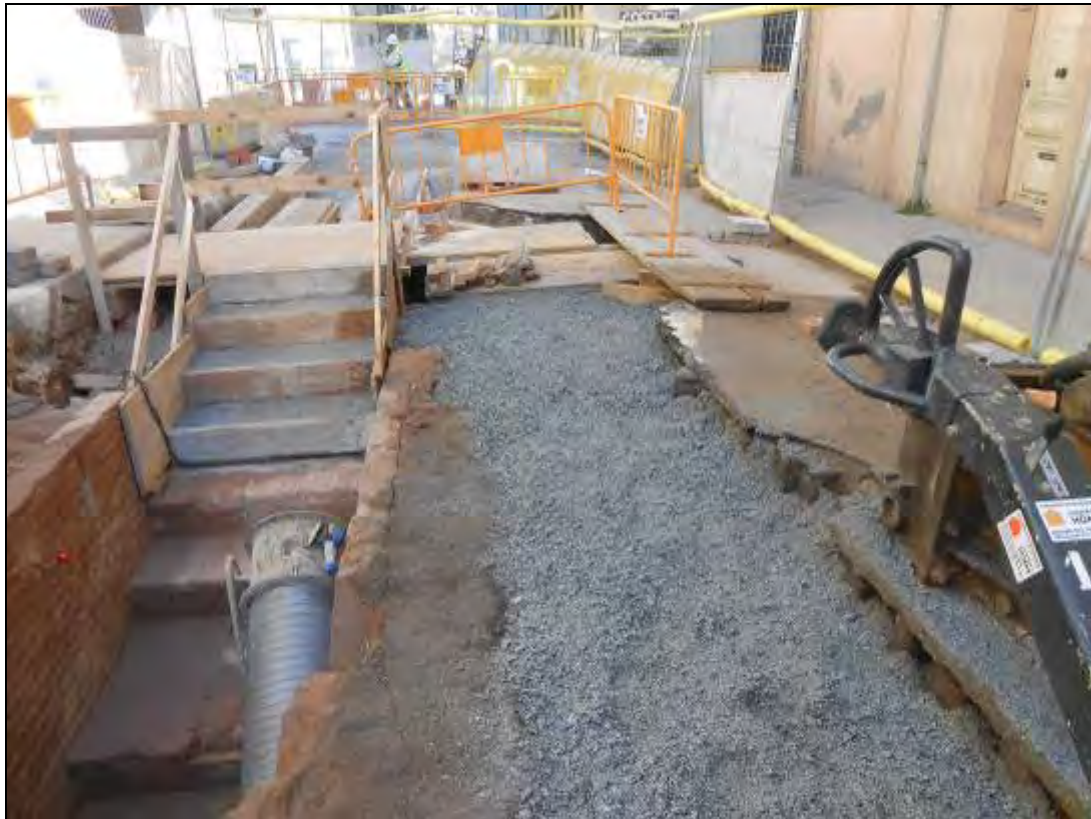
Foto 60: Tram 1. Rasa per a col·lector al costat del refugi. Procés de l'obra.
