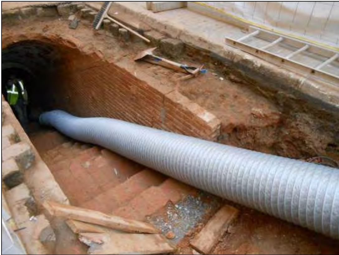
Foto 250: Tub de ventilació.
