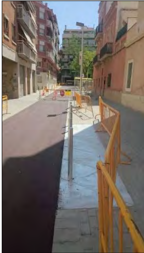
Foto 114: Tram 1. Vista de la tapa del refugi un cop finalitzada l'obra del carrer.
